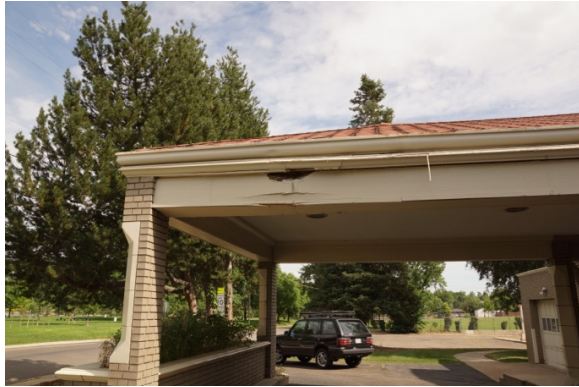
4044: Porte cochere damage
