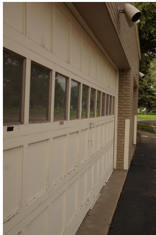
4028: Garage door sag
