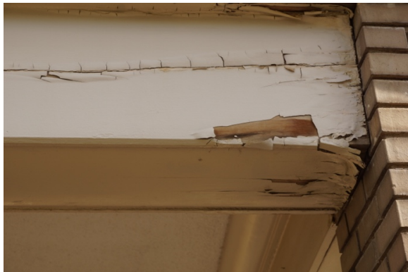
4036: Porte cochere damage
